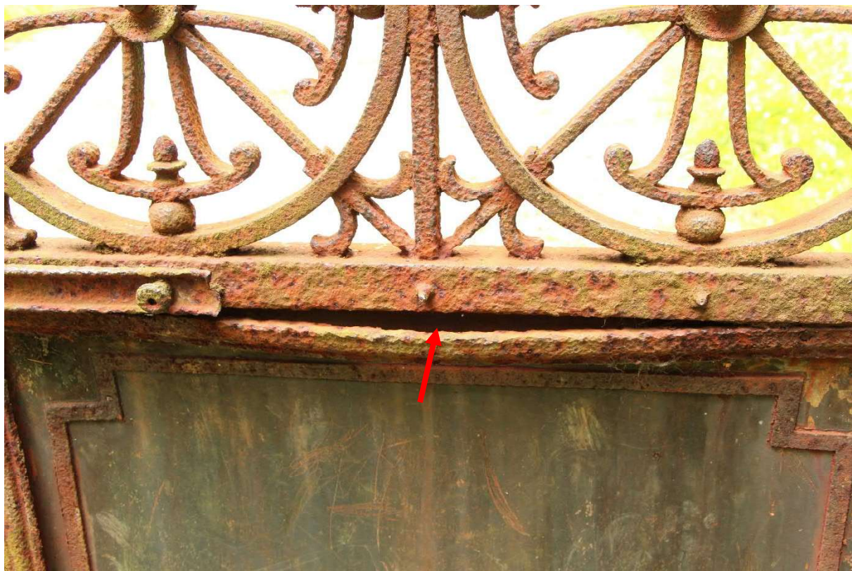
Detail roztržení naloženého ozdobného pásu na měděné výplni, ozdobný B profil chybí
