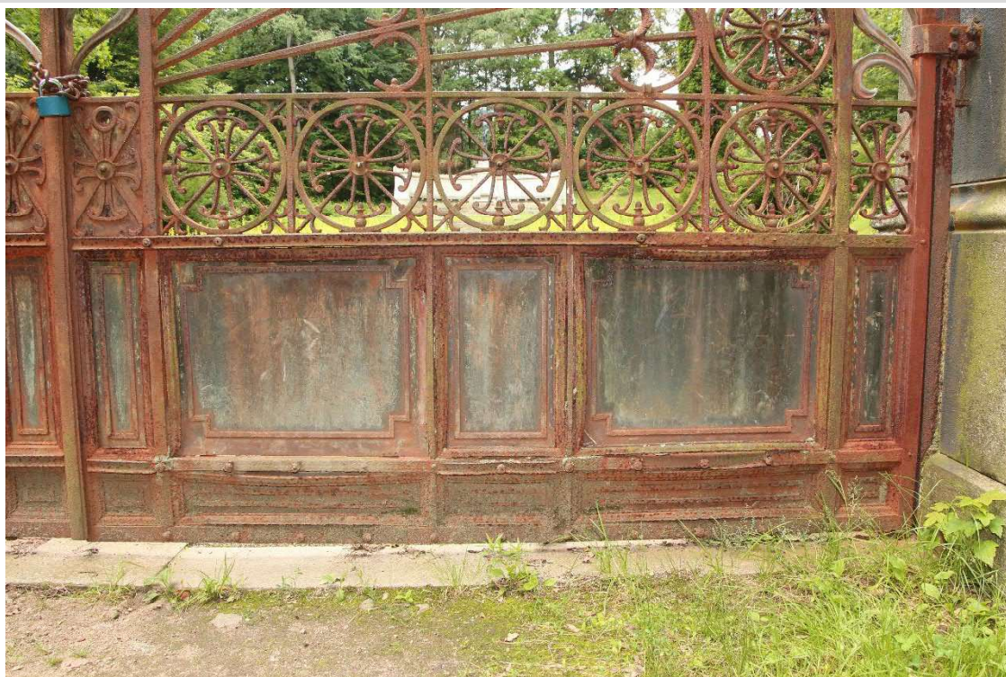
Spodní část brány je zničená působením koroze
