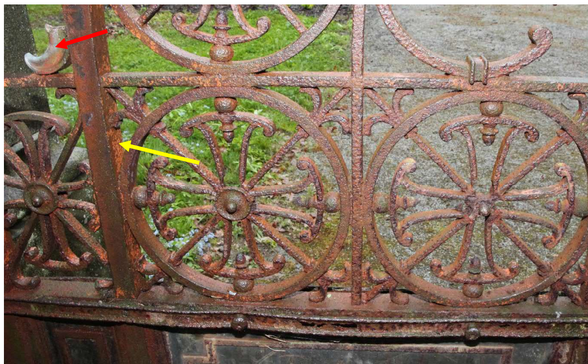
Zde je vidět zkorodovaný povrch po celé ploše, zbytky suříkového nátěru a torzo zinkové ozdoby
