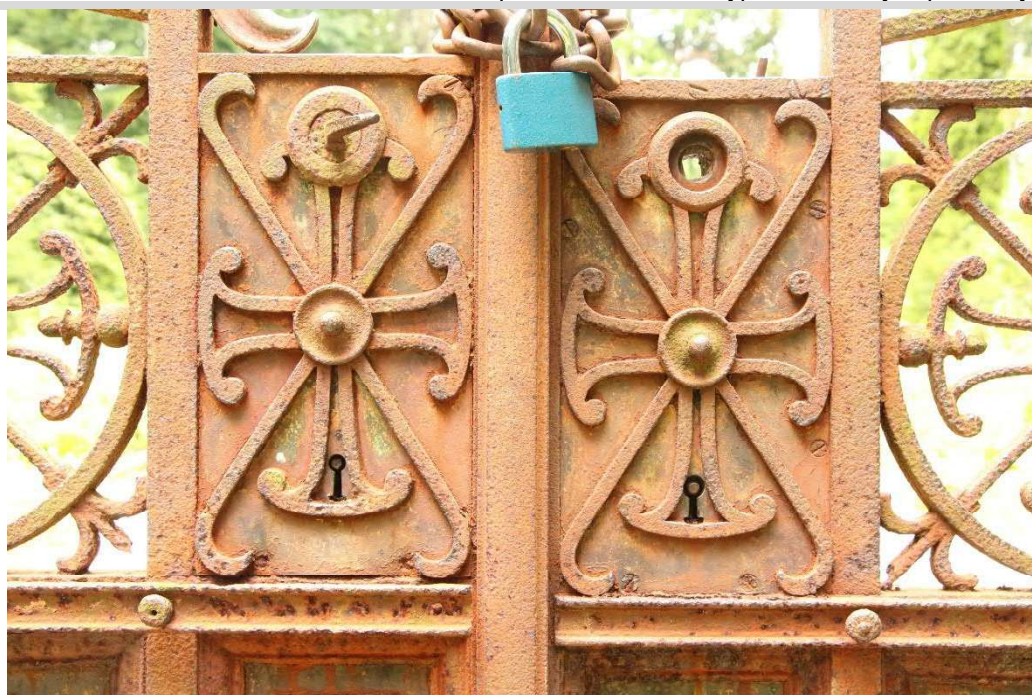
Detail zámku, chybí kliky - 2 páry, je patrné svěšení pravého křídla
