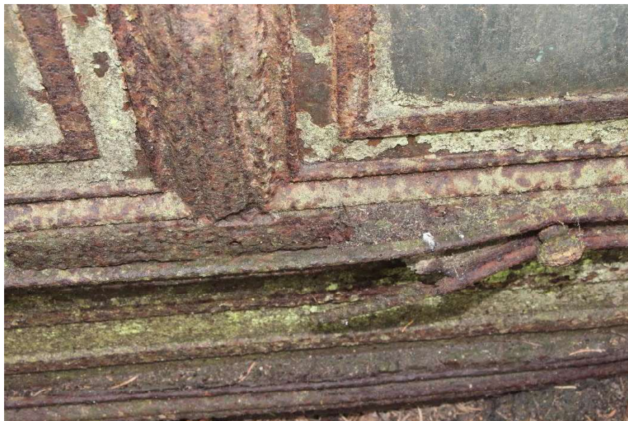
Spodní část brány je zničená působením koroze
