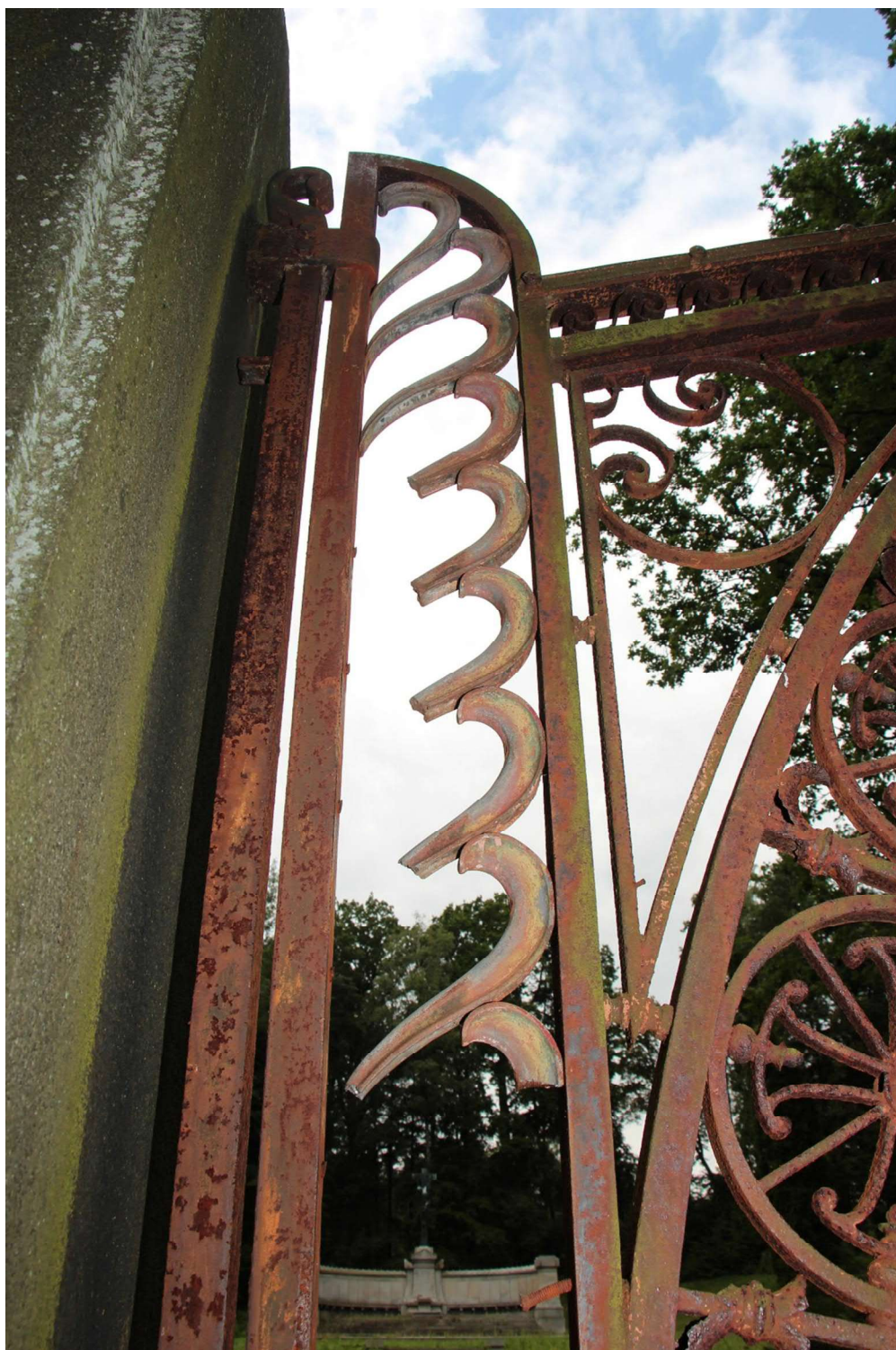
Detail poškozených a chybějících odlévaných prvků ze zinku osazených na bráně
