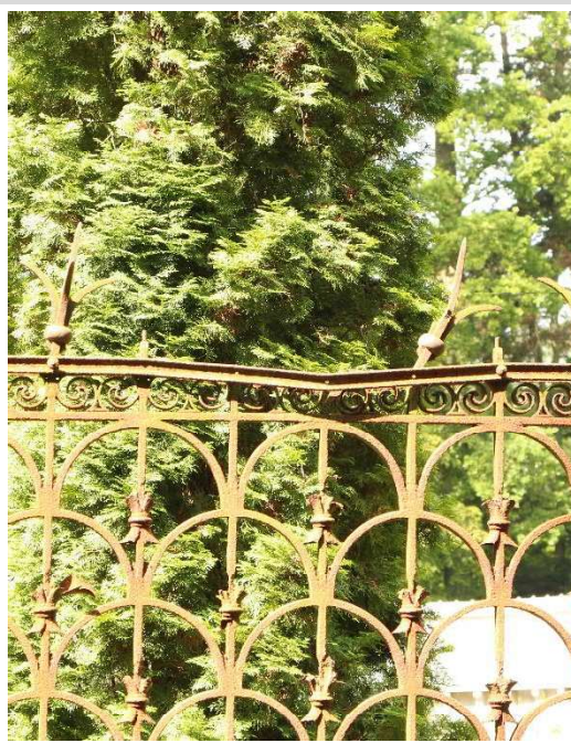
Detail mechanického poškození
