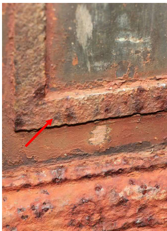
Korozí poškozené rámečky na měděné výplni
