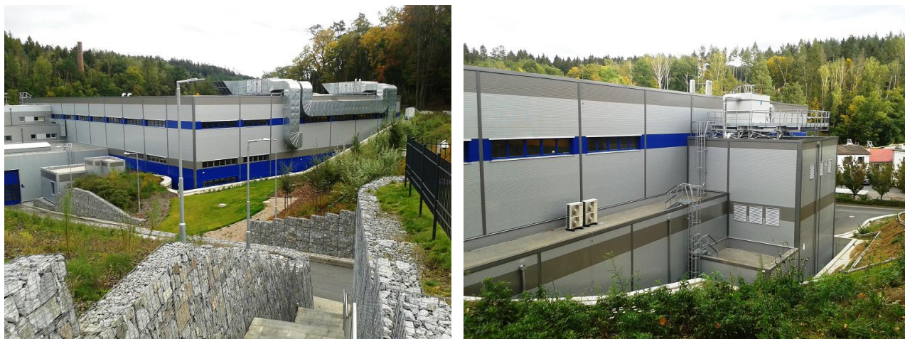
Obrázek 3 VZT jednotky na střeše nové výrobní haly, chladič Baltimore a dvě menší chladicí jednotky na střeše přístavku
